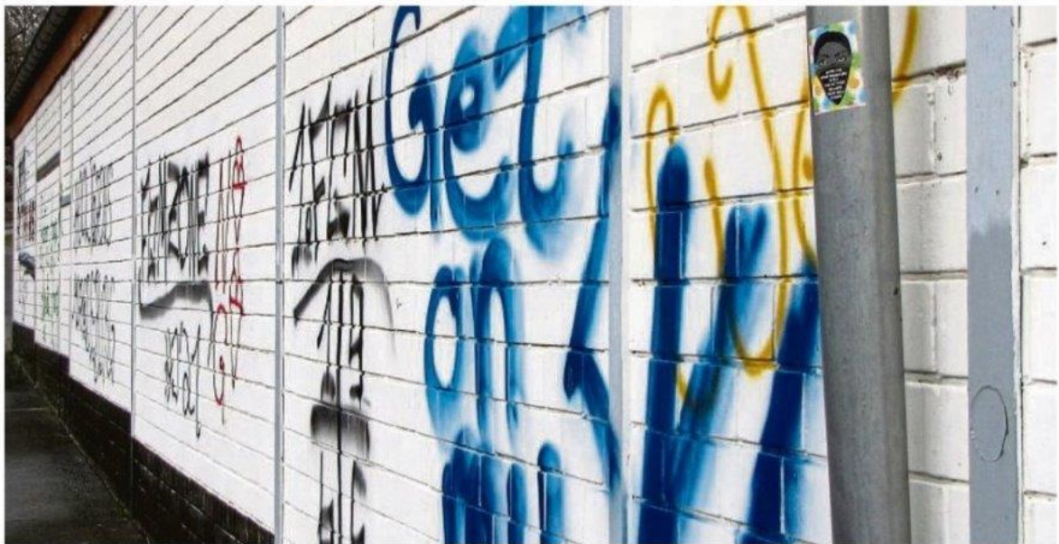
Das wäre ein Fall für den Mangel-Melder der Stadt Bad Sooden-Allendorf: Schmierereien auf breiter Front am Bootshaus nahe dem Werra-Ufer in Allendorf. FOTO: CHRIS CORIIS
